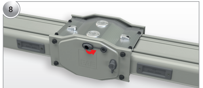
8 Döküm yapılacak bölgenin plastik kapağı açılır. Dikkat: Busbar duruş yönüne göre yukarıda olan plastik kapaktan dolum işlemi yapılır.
